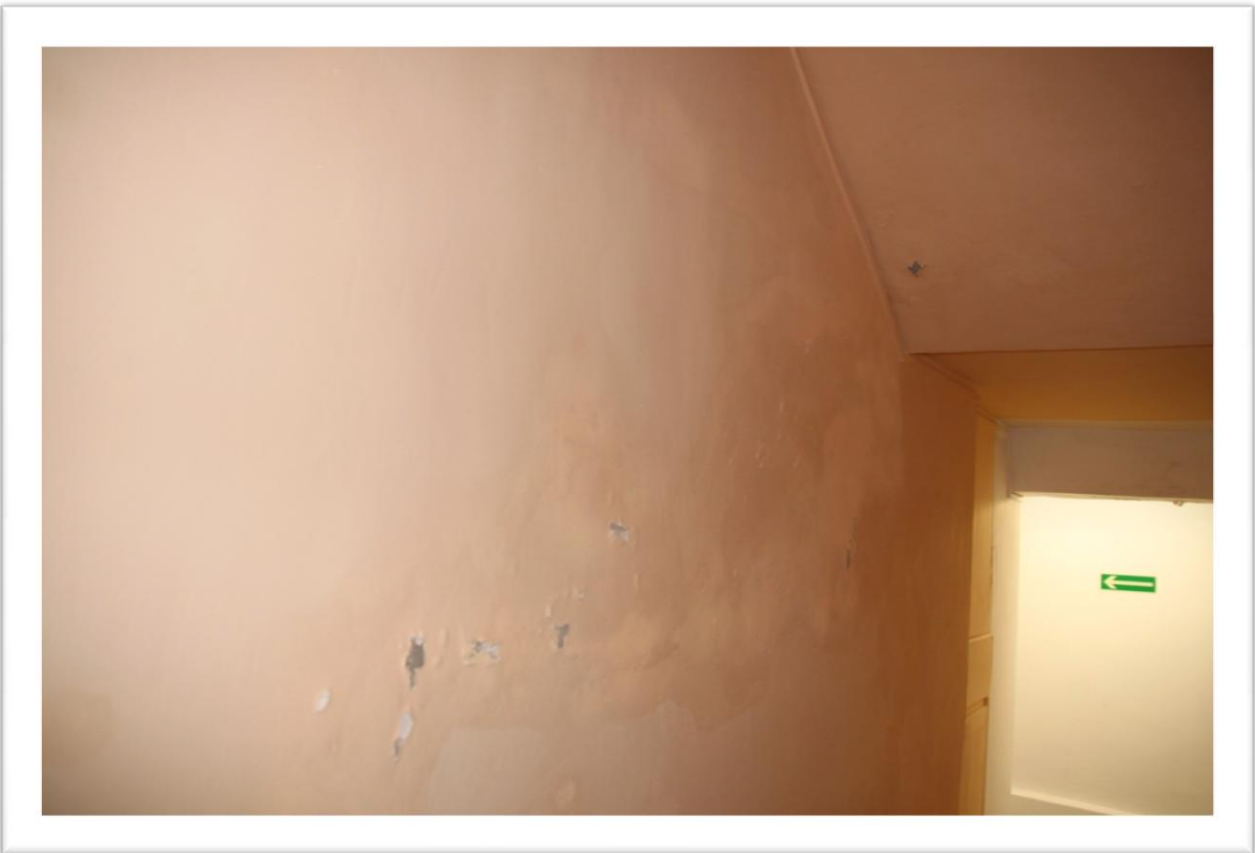
Fot. Nr 9 i 10 Zawilgocone powłoki tynkarskie w piwnicy.
