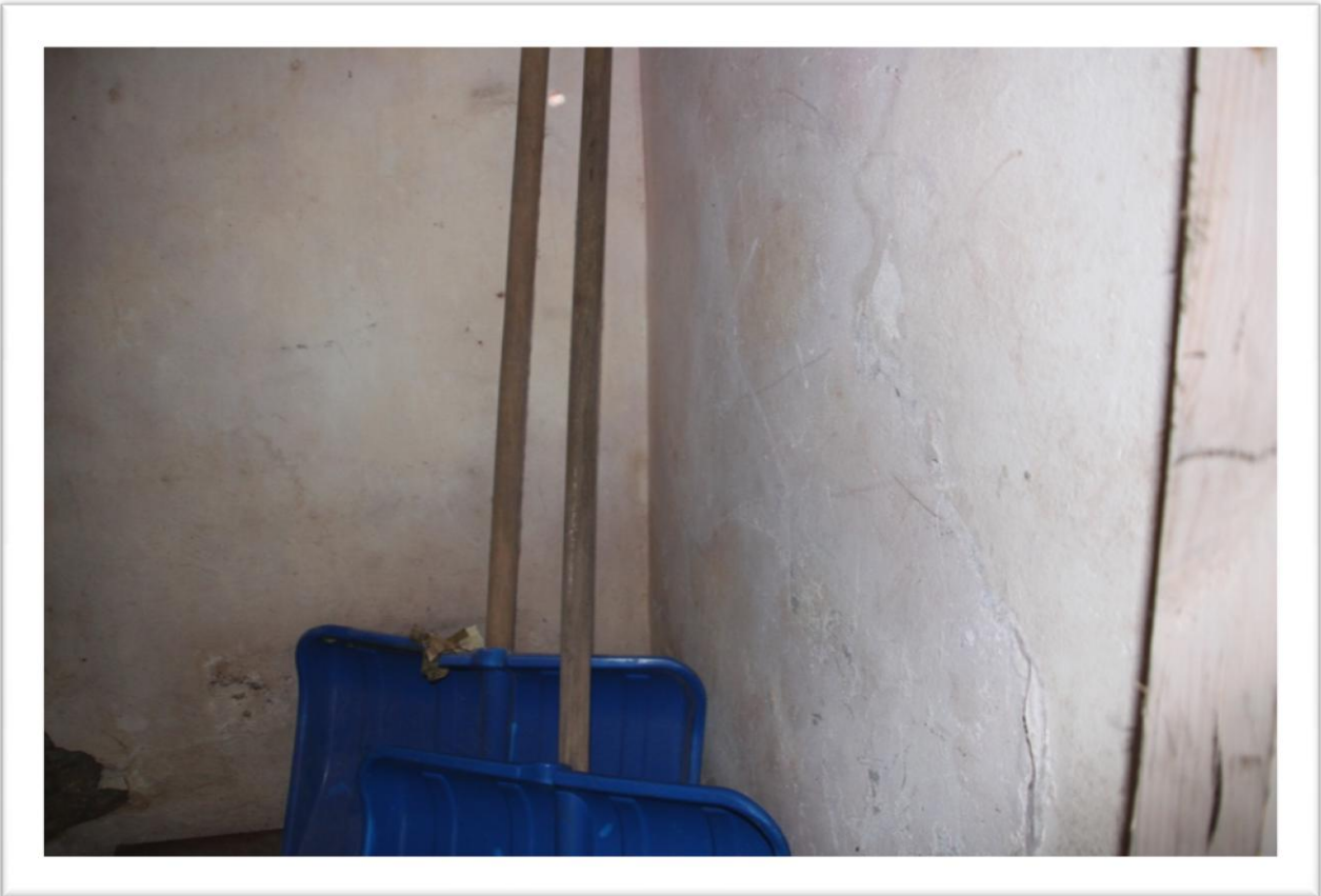
Fot. Nr 12 i 13 Zniszczony tynk zawilgoconych ścian- schowek pod schodami.
